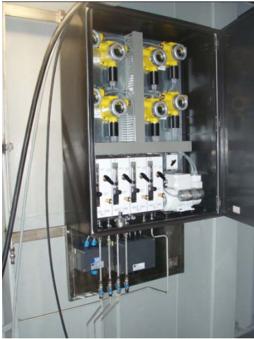
Kontrollskap montert lokalt (cargorail).
