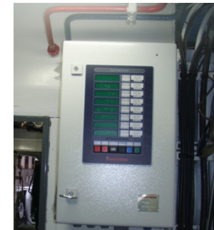
Alarmkabinett montert sentralt i innredning.
