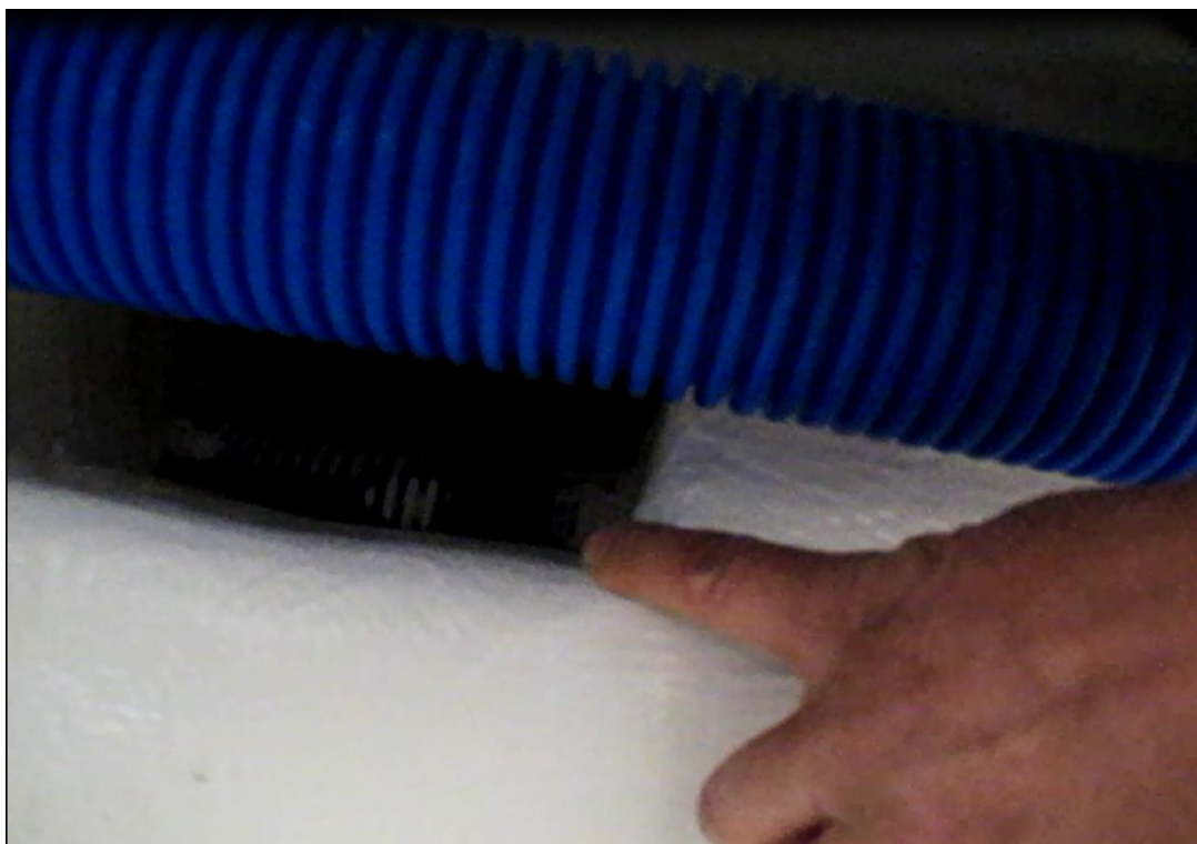
Figur 6 Bildet er tatt av ulykkesbåten i etterkant av ulykken. Bildet er fra styrbord side i rommet under luka. Fingeren peker på en åpning i avgrensingsskottet mellom dette rommet og øvrig volumn under dørken. På yttersiden av avgrensingsskottet ble det observert vann. Foto: SHT.
